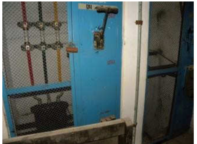
Здание подстанции и компрессор
