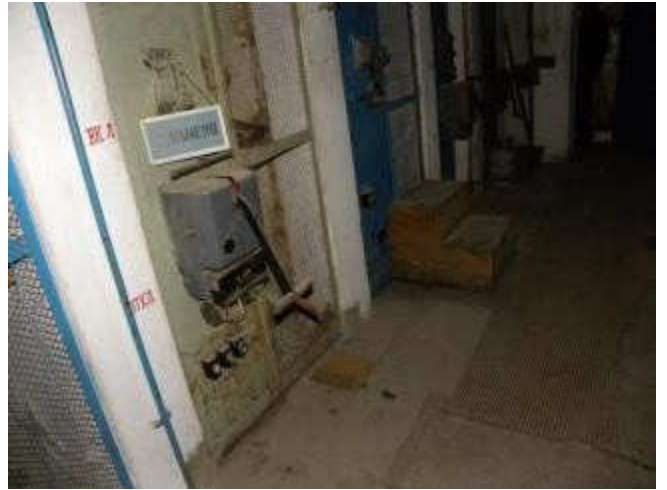
Здание подстанции и компрессор
