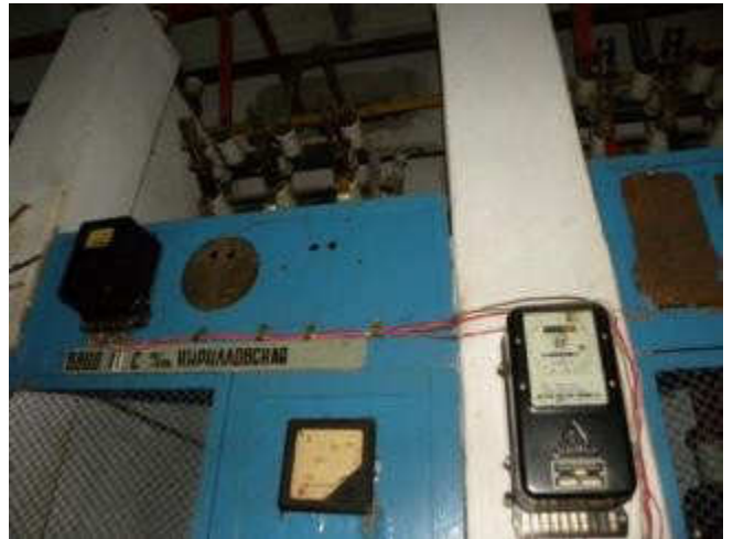
Здание подстанции и компрессор
