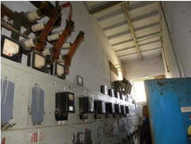
Здание подстанции и компрессор
