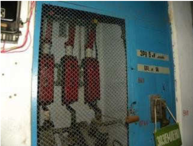
Здание подстанции и компрессор
