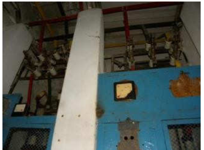
Здание подстанции и компрессор
