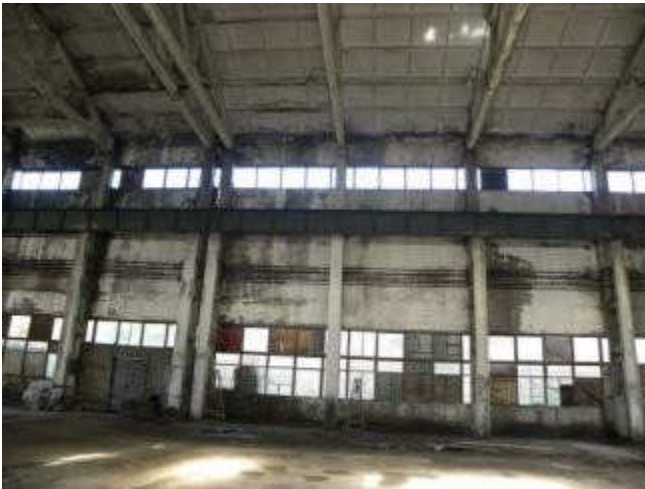
Цех редукторных пар (СМ-1) вид внутри
