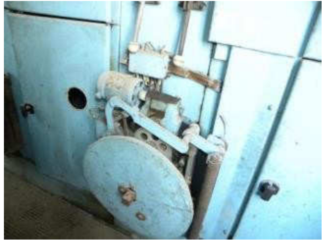
Здание подстанции и компрессор
