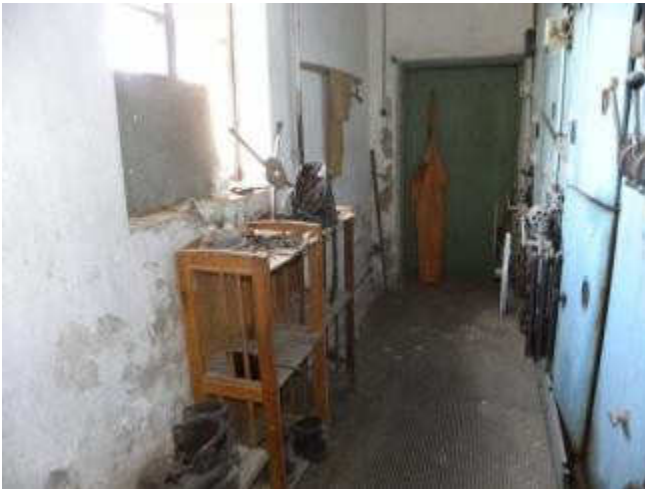
Здание подстанции и компрессор
