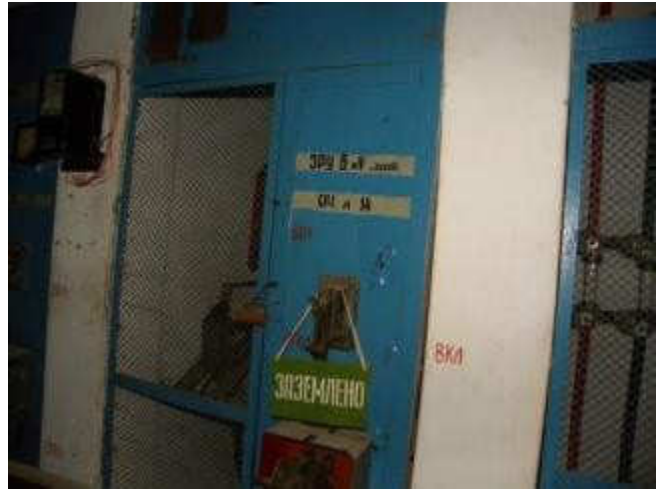
Здание подстанции и компрессор
