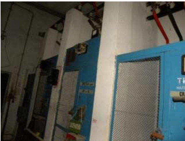
Здание подстанции и компрессор
