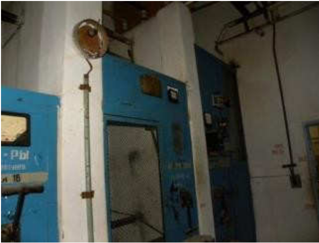
Здание подстанции и компрессор
