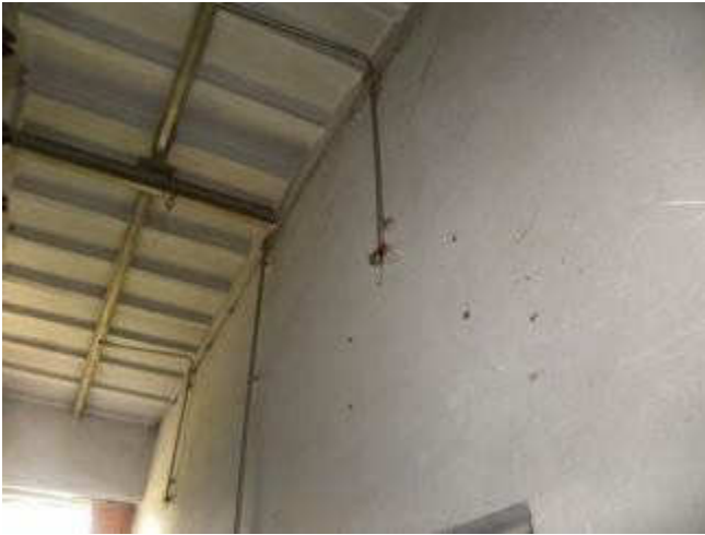
Здание подстанции и компрессор
