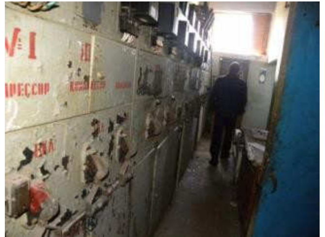
Здание подстанции и компрессор
