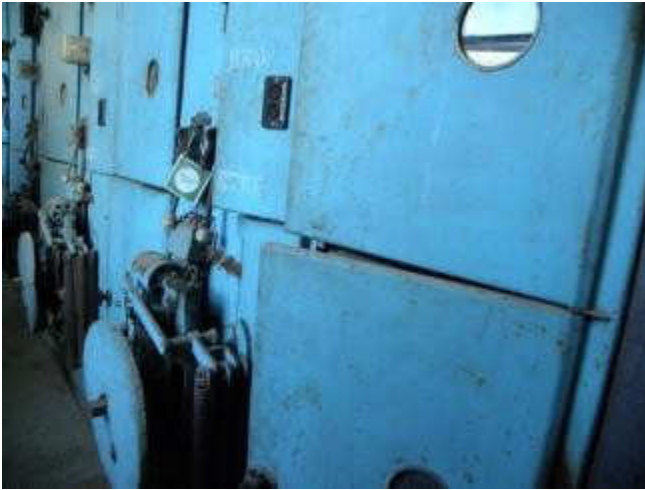
Здание подстанции и компрессор
