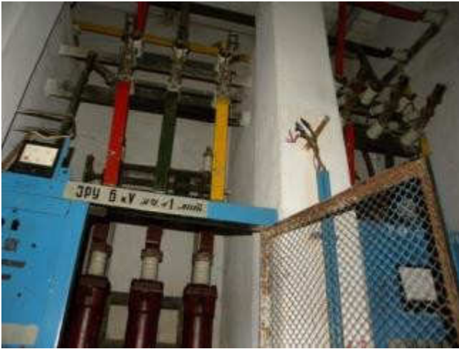
Здание подстанции и компрессор
