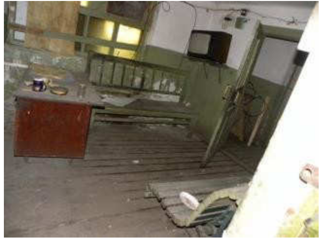
Здание подстанции и компрессор
