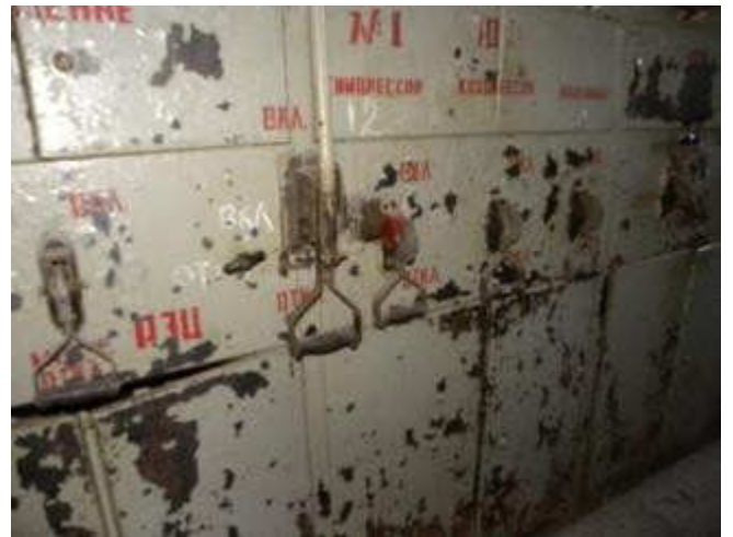
Здание подстанции и компрессор
