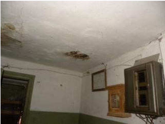
Здание подстанции и компрессор
