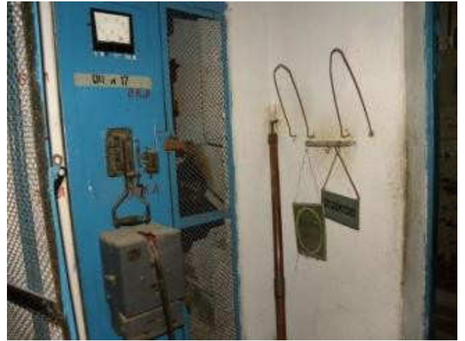
Здание подстанции и компрессор
