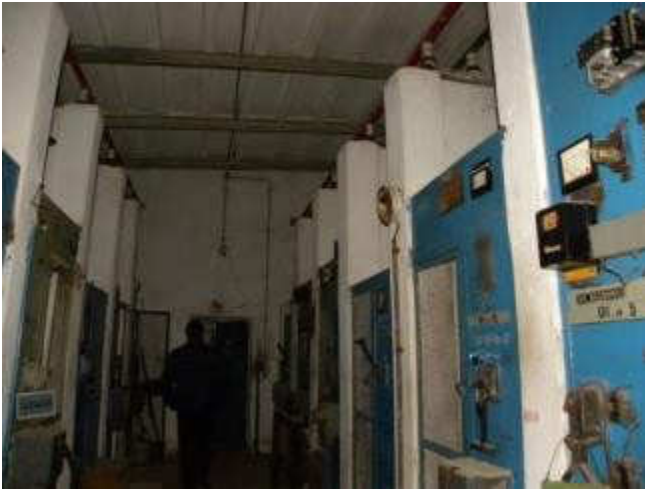
Здание подстанции и компрессор
