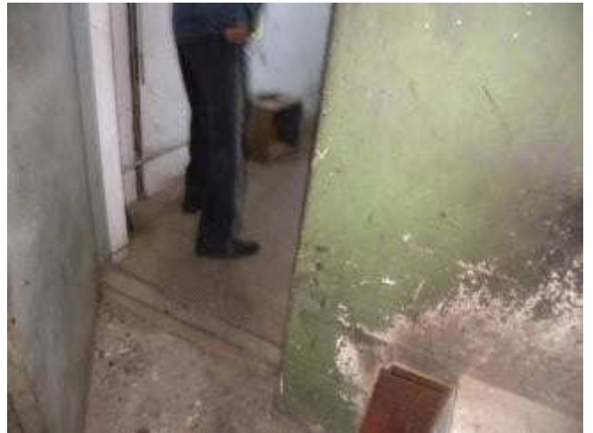
Здание подстанции и компрессор
