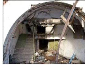
Фото 11. Состояние лестничных пролетов
