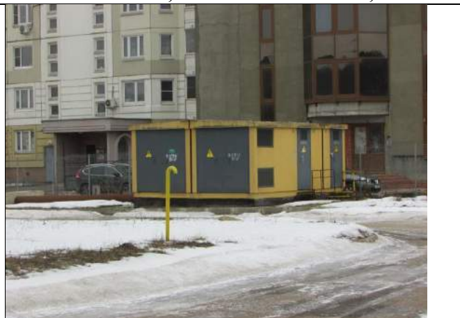
Кабельная линия 0,4кВ Павшинская пойма, 00001037
