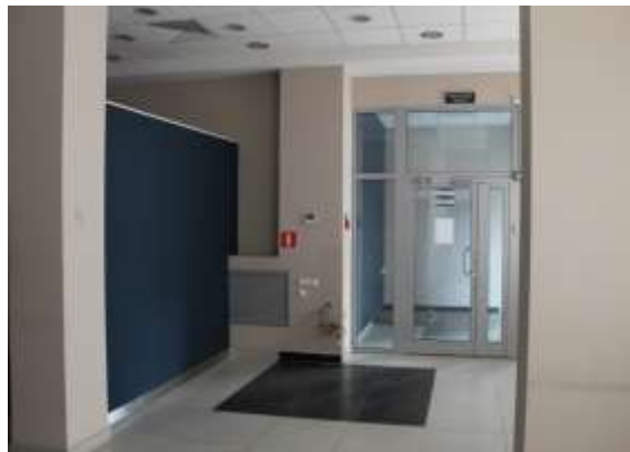
Фото 22. Техническое состояние помещений
