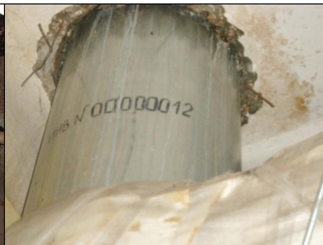
Дымосос Д №3,5У (3*1500)
