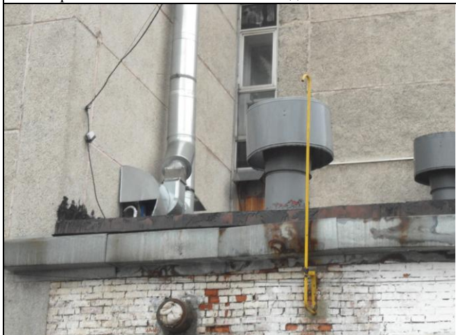
Дымосос Д №3,5У (3*1500)
