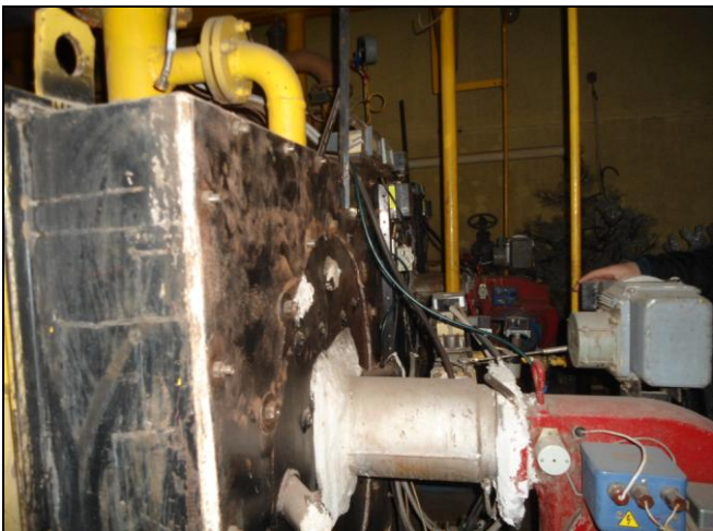
Котел КВА-1 №1 и №2
