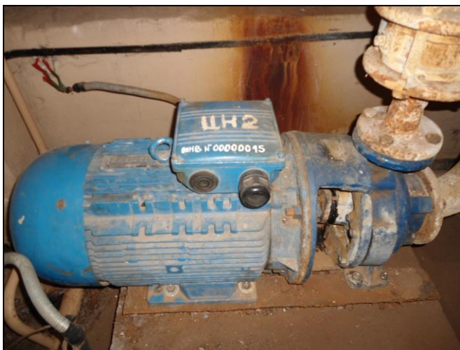
Агрегат насосный КМ 80-50-200 с двигателем 15кВт
