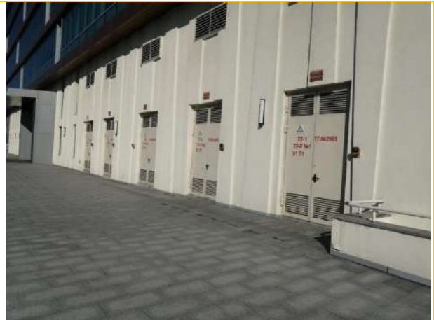
Общий вид здания, внутривозвездочные сети, инженерное обеспечение. Сеть электроснабжения (РУ-0,4 кВ 2 шт., ТП-2 шт.)
