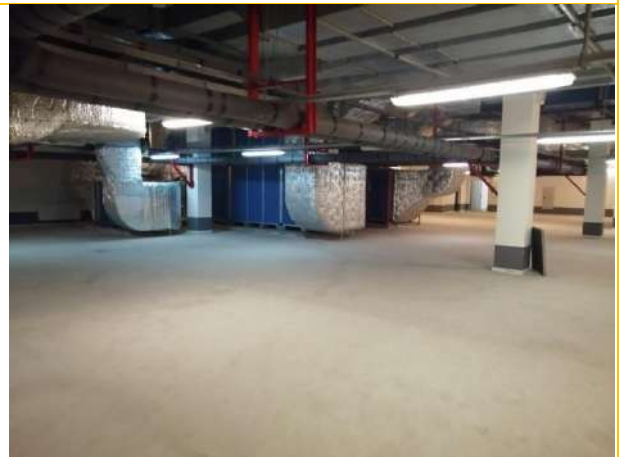
Состояние помещений – 8 этаж (Внутриплощадочные сети, инженерное обеспечение. Теплоснабжение газопроводное. Крышные газ.котельн. 2 шт. )
