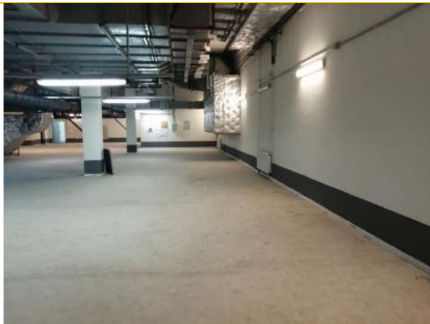
Состояние помещений – 8 этаж (Внутриплощадочные сети, инженерное обеспечение. Теплоснабжение газопроводное. Крышные газ.котельн. 2 шт. )
