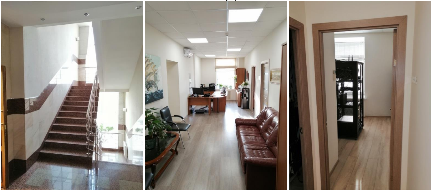
Фото 14-16. Состояние внутренней отделки
