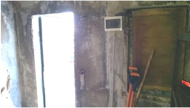
Щиток электроэнергети в котельной
