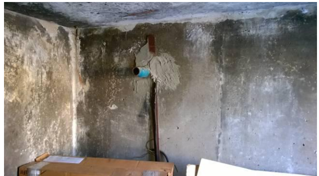
Котельная. Выход трубы отопления не присоединен к котлу, отопительное оборудование отсутствует
