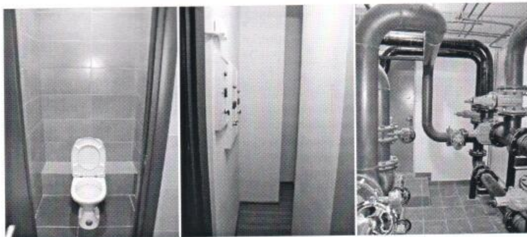
Фото № 7,8,9 Коммуникации и сантехническая комната.
