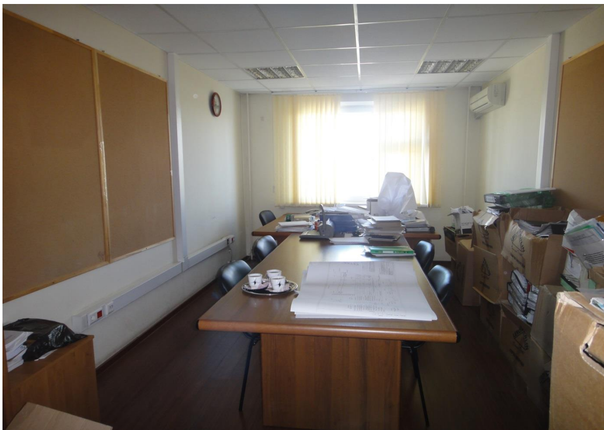
Фото 11. Офисное помещение, состояние отделки
