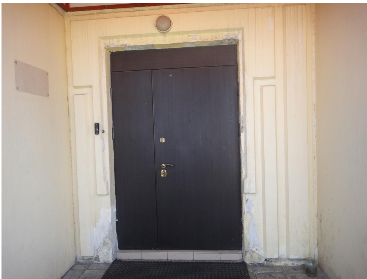
Фото 5. Вход в оцениваемое помещение, повреждения штукатурки и покрасочного, трещины
