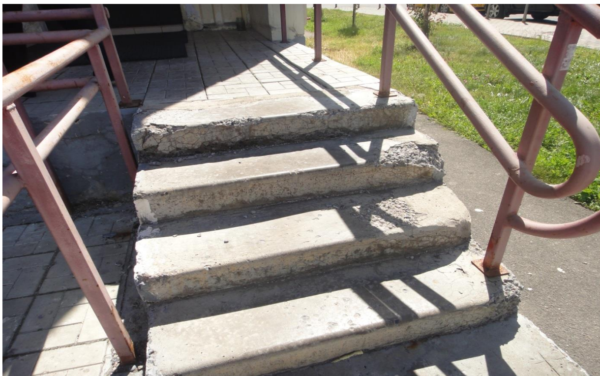
Фото 4. Деформации бетонных ступеней лестницы у входа в оцениваемое помещение
