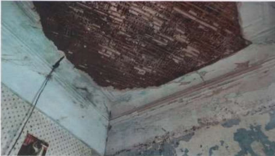
Фото № 12. Обрушения потолочного лепного декора помещения первого этажа.
