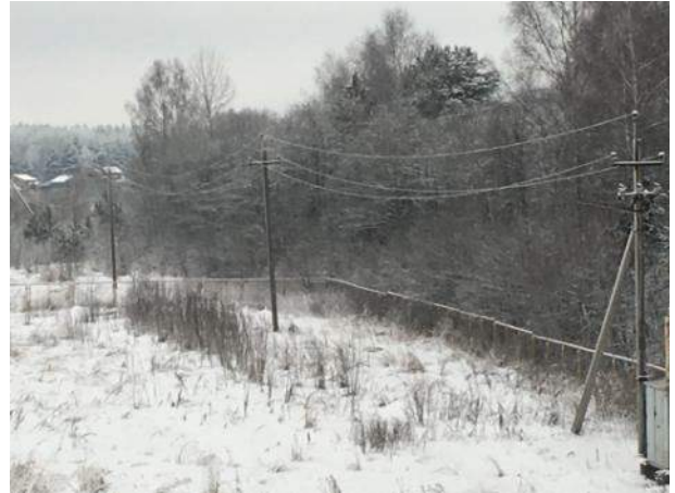
Линия электропередач ВЛ-10кВ
