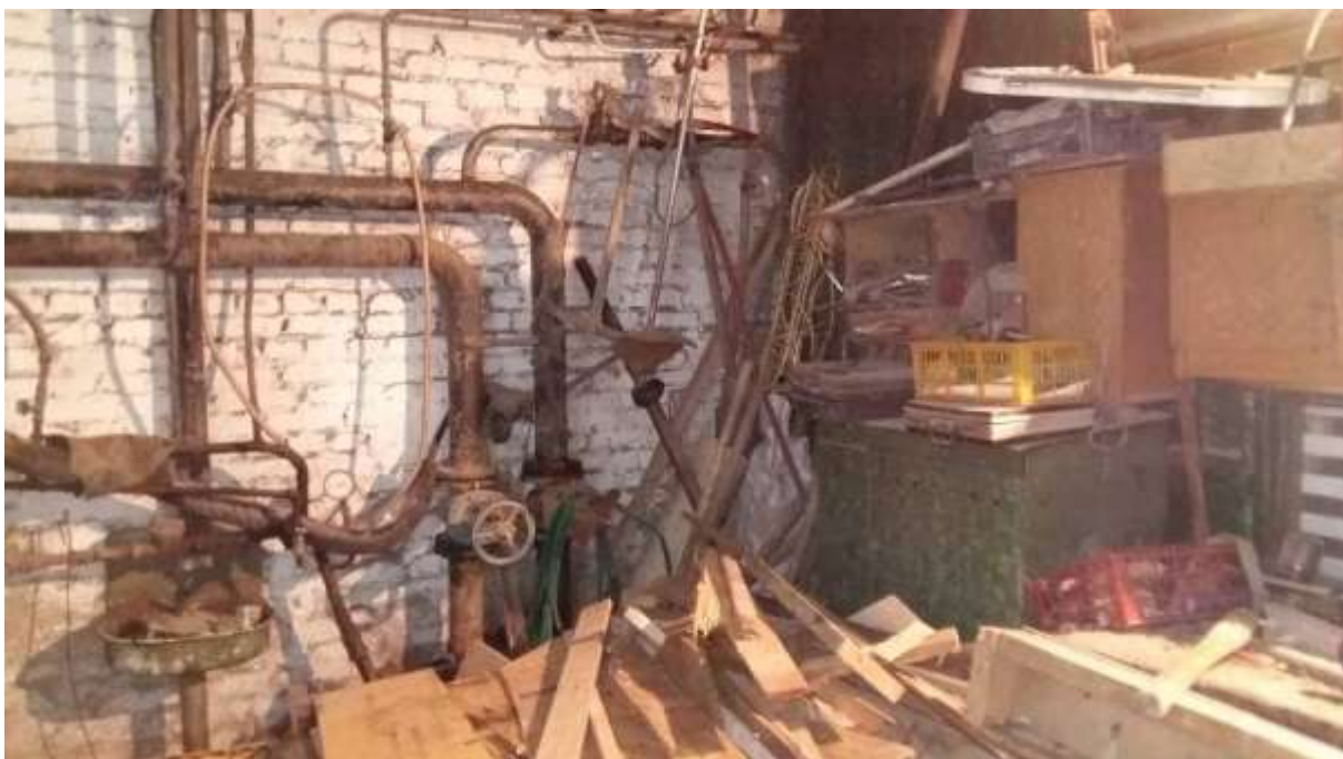
Коммуникации в котельной
