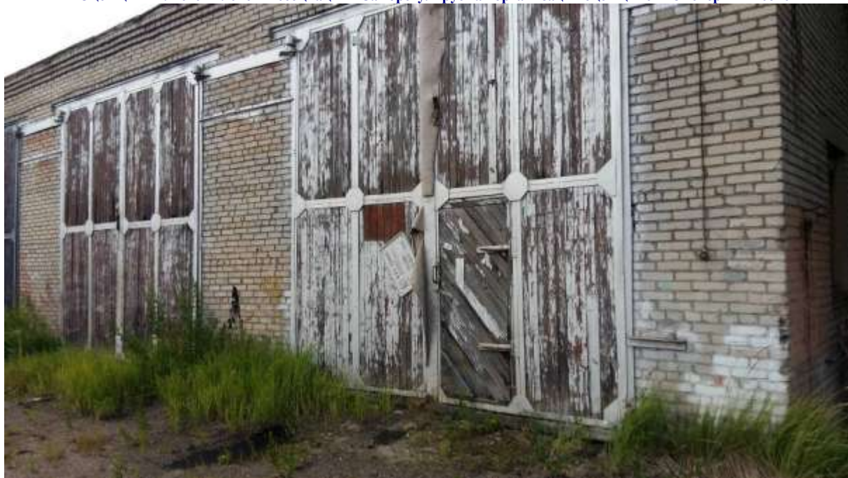
Боксы для ремонта машин 472,4 кв.м с права по территории базы
