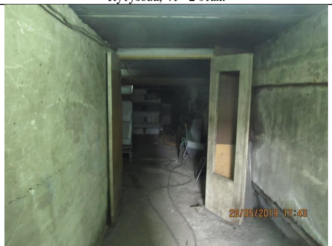
Здание, расположенное по адресу: г. Новокузнецк, ул. Кутузова, 41– подвал
