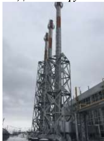
Фотография 6.74 Дымовые трубы
