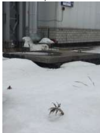
Фотография 6.76 Канализация / водосток
