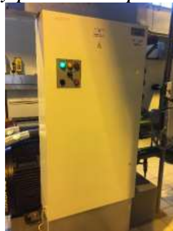
Фотография 6.38 Шкаф управления пожарным насосом
