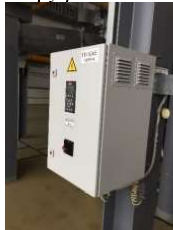
Фотография 6.10 Шкаф управления с ЧРП
