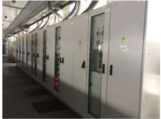
Фотография 6.24 Низковольтное комплектное устройство РУСН-0,4
