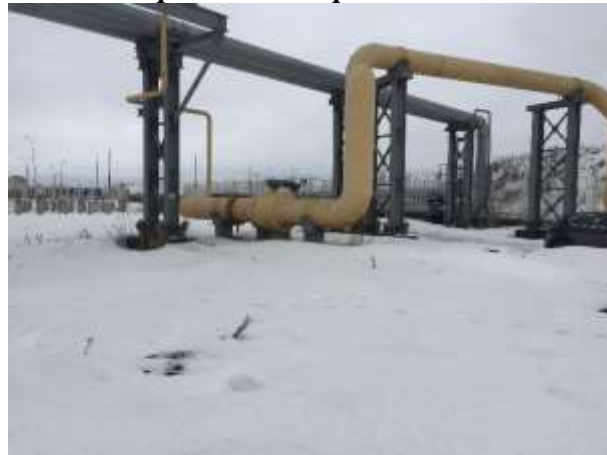
Фотография 6.78 Теплотрасса / газопровод / эстакада
