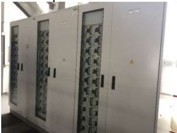
Фотография 6.17 Шкаф 2400x1200x600 УХЛ4
