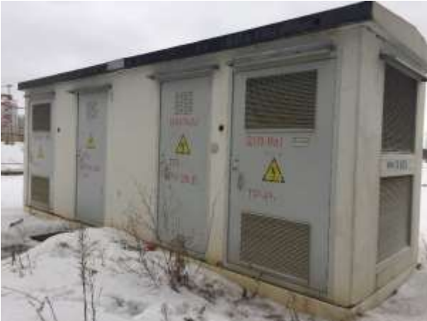
Трансформаторная подстанция Вид 1
