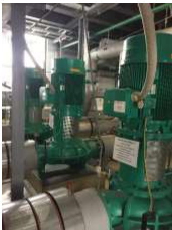
Фотография 6.7 Насосы первого подъема Wilo IL250/360-75/4 вид 1
