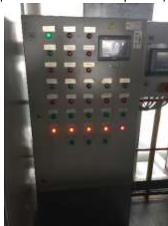
Фотография 6.18 Щит автоматизации ЩА-1
