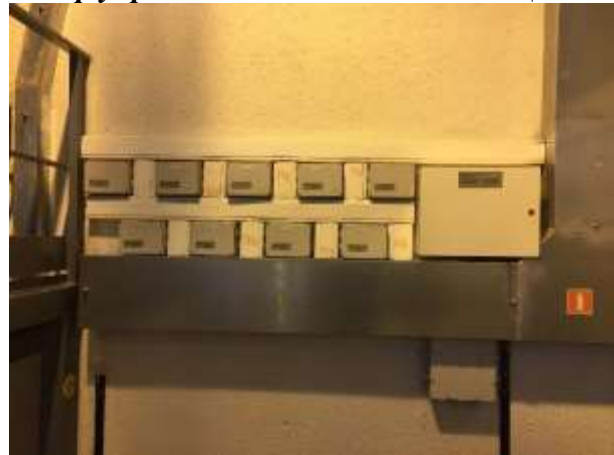
Шкаф управления Посейдон Салт ЩУ-Р43
