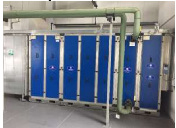
Фотография 6.28 Приточная установка
