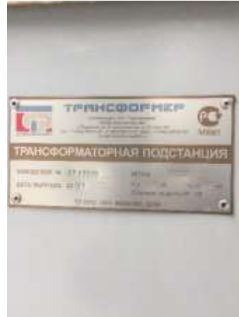
Трансформаторная подстанция Вид 2
