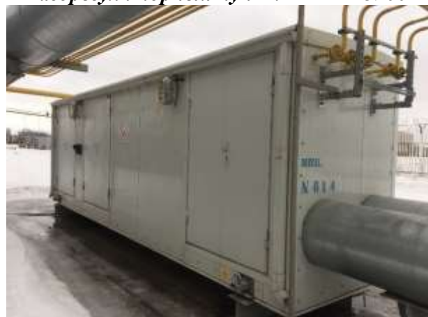
Газорегуляторный пункт ГРПШ-5900
