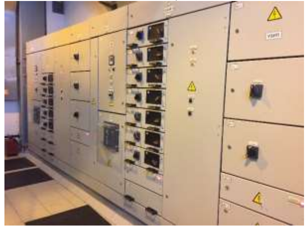
Фотография 6.36 Низковольтное комплектное устройство РУСН-0,4
