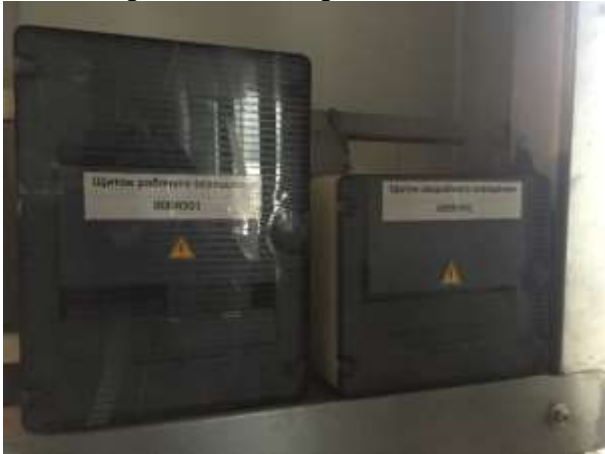
Щиток рабочего / аварийного освещения
