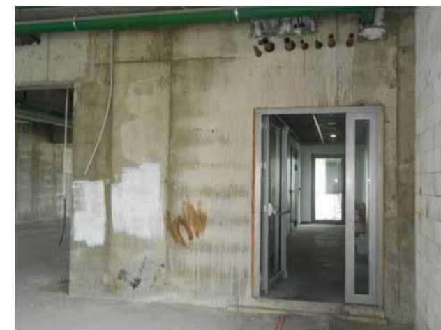
Фото 13. Общий вид внутри БЦ
