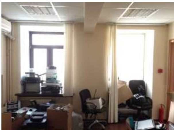
Рис. 7.27. Техническое состояние внутренних помещений оцениваемого объекта
