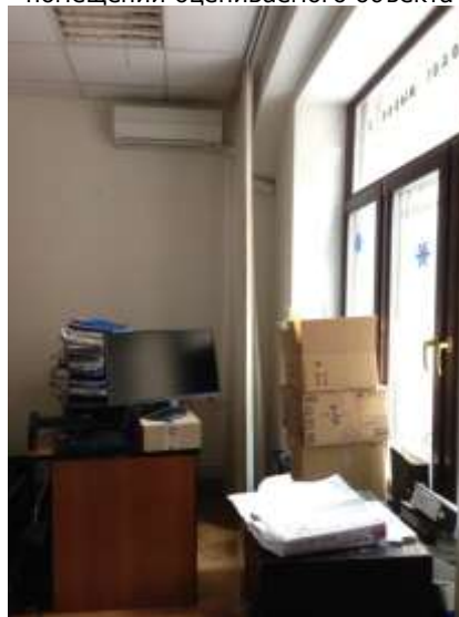
Рис. 7.22. Техническое состояние внутренних помещений оцениваемого объекта
