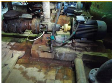
Фото 19. Оборудование водопроводного устройства
