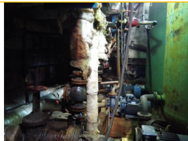
Фото 20. Оборудование водопроводного устройства
