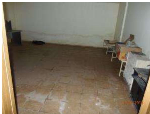
Рисунок 7.23. Состояние помещений в цокольном этаже
