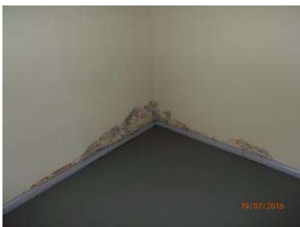
Рисунок 7.16. Последствия недостаточности отопления
