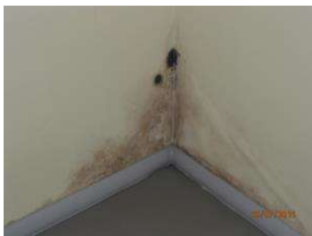
Рисунок 7.17. Последствия недостаточности отопления
