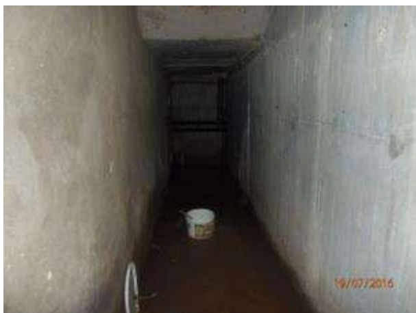
Рисунок 7.24. Талые и дождевые воды в цокольном этаже
