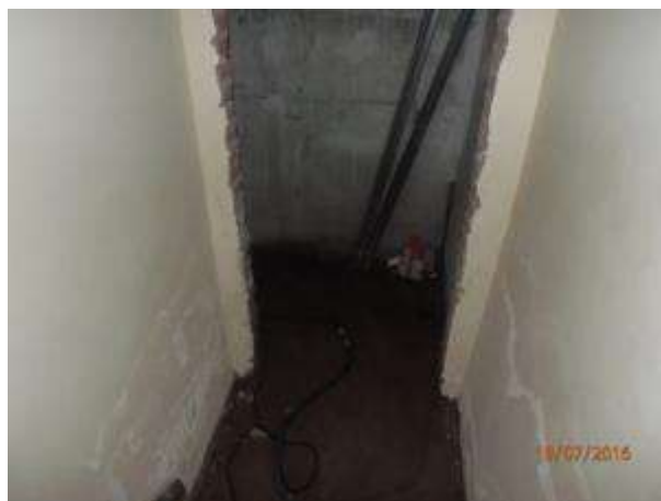
Рисунок 7.25. Состояние помещений в цокольном этаже
