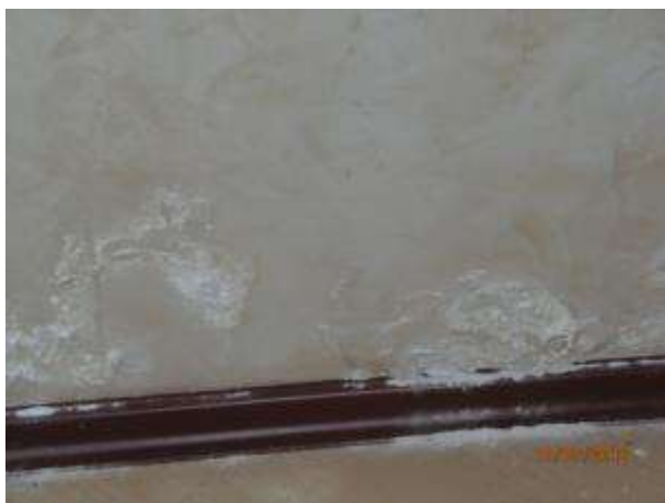
Рисунок 7.14. Последствия недостаточности отопления
