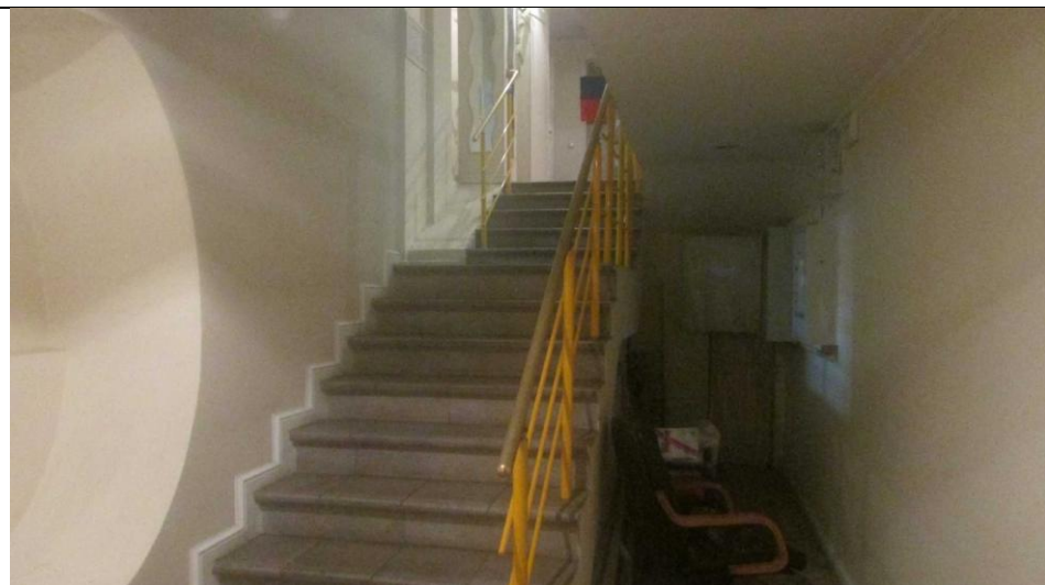
Рисунок 6.57 Лестница (помещение №11), подвал
