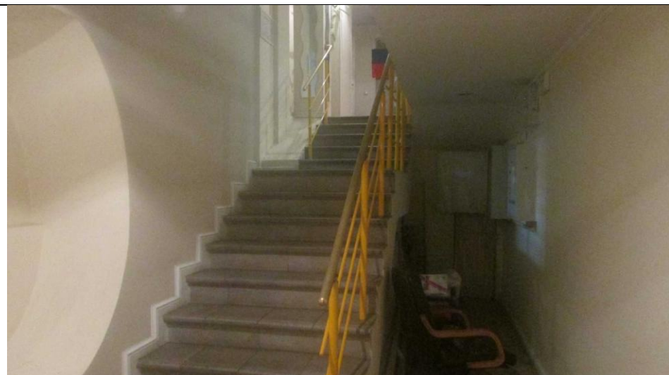
Рисунок 6.58 Лестница (помещение №11), подвал
